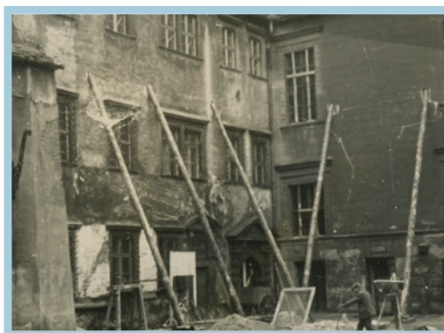
Remont ratusza w Nysie – widok na drewniane podpory budynku od strony północnej, zbliżenie. W rogu przejście na ul. Wieżową (Turmgasse), 1935-1936
